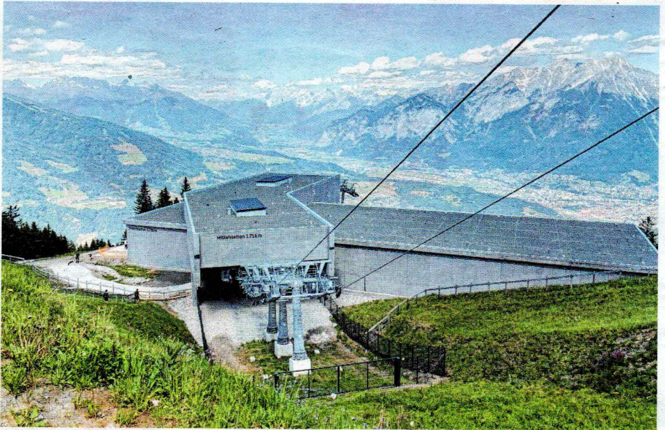
Die zweite Sektion der Kofelbahn ist aufgrund eines Motorschadens nicht in Betrieb.
